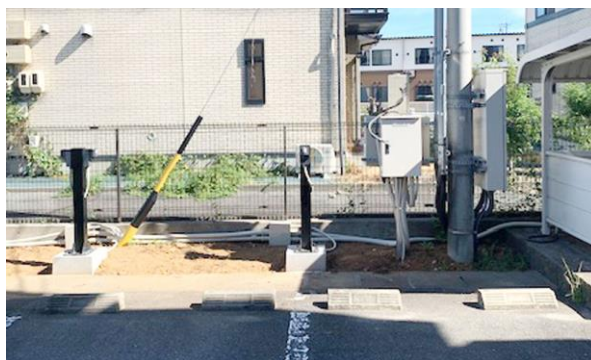
導入設備：ポール型 充電スタンド（11台分）
