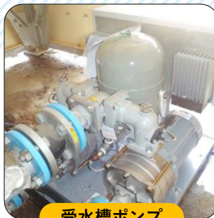
受水槽ポンプ
